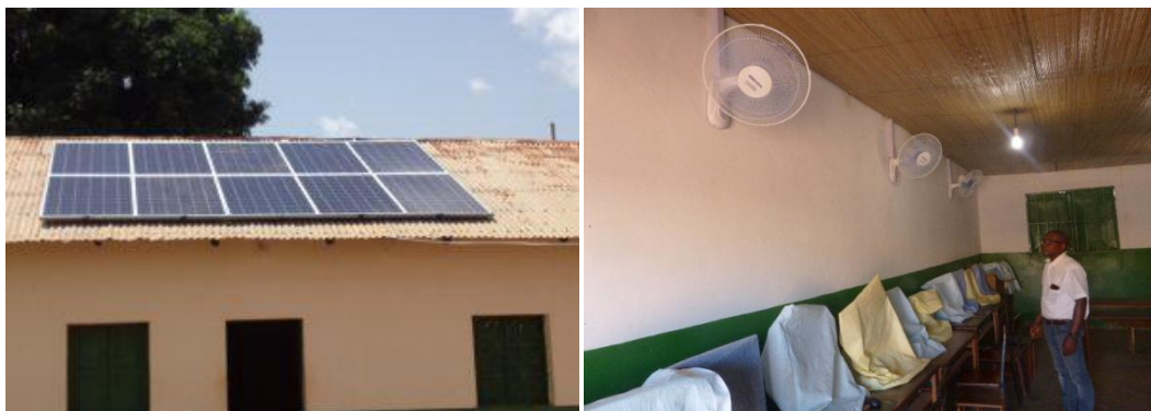
Foto: De geïnstalleerde zonnepanelen en de ventilatoren in het computerlokaal
